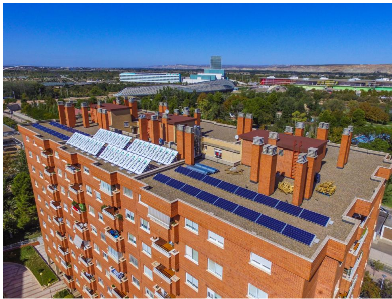
Instalación de paneles solares híbridos en un edificio de viviendas. | Abora Solar
