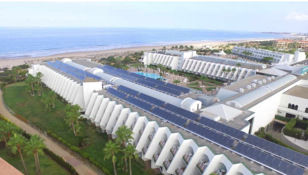
Instalación en el hotel Iberostar Royal Ándalus, Chiclana (España)
